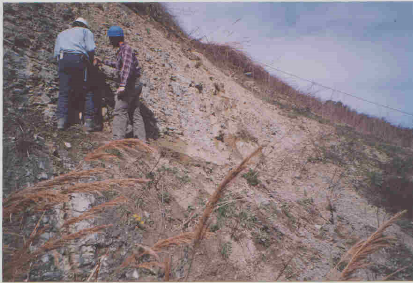
Fotogramma 5. Stazione di rilievo geomeccanico numero 2; ubicata a monte della linea ferroviaria Faenza-Firenze.
